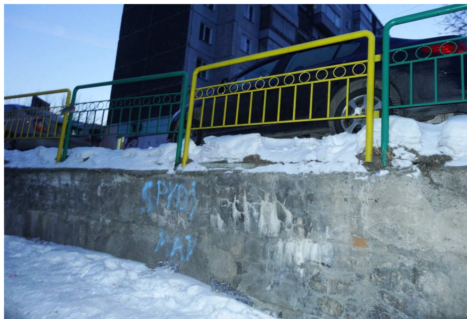
Рис. 2. Фрагмент подпорной стены после «ремонта».
