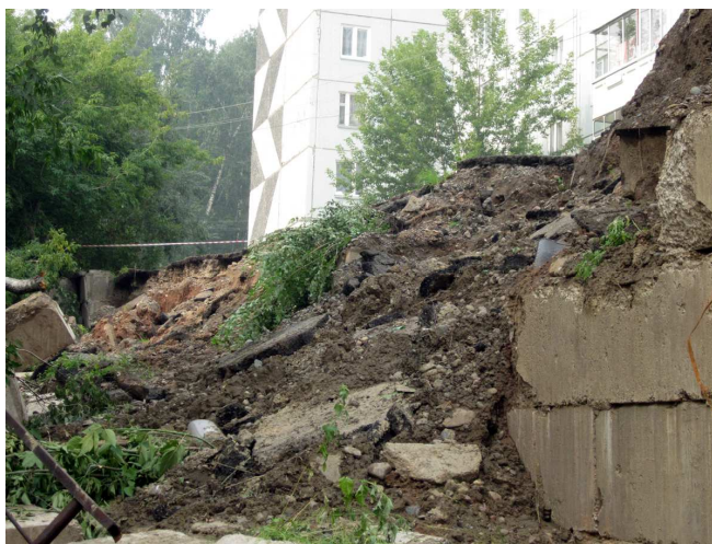
Рис. 3. Обрушение подпорной стенки у дома № 24 в Академгородке 3.08.2013 г.
