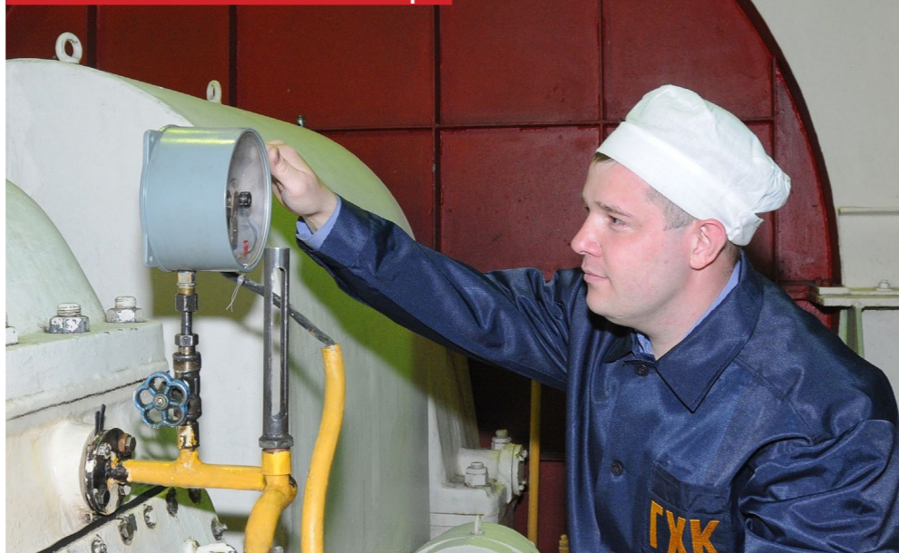
Инженер по вентиляции технологического цеха реакторного завода Максим Качура проверяет работу вентилатора, который снабжает воздухом подгорную часть комбината
