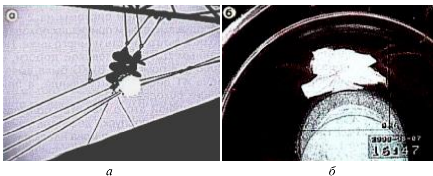
Рис. 2. Дефектная гирлянда из трех фарфоровых изоляторов ПФ70: а – двухспектральное изображение гирлянды; б – внешний вид дефекта нижнего изолятора (скол фарфора в районе стержня)
