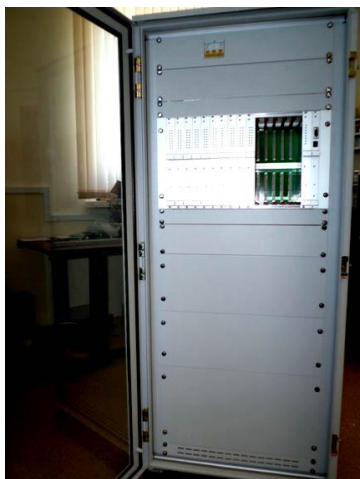
Рисунок 3 – Шкаф подсистемы сбора данных в ходе эксперимента
